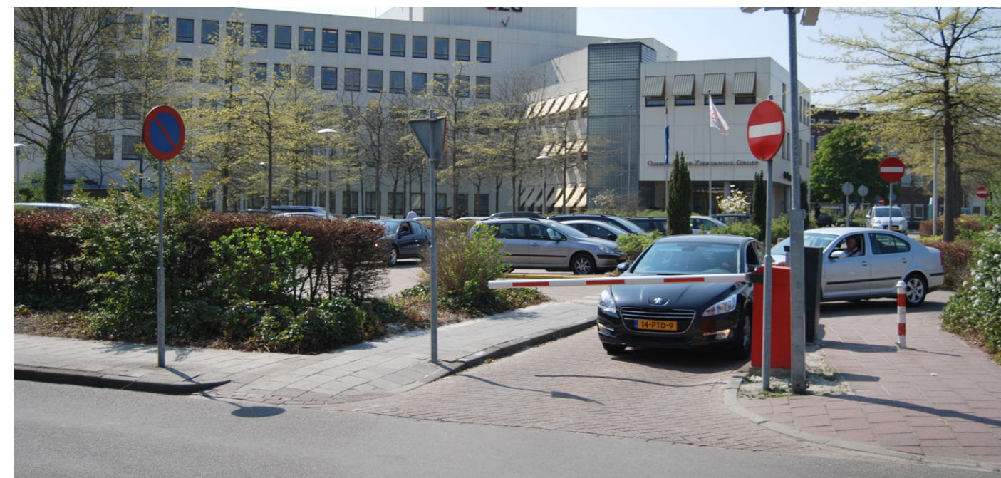
Grote transformatielocatie St. Lucas locatie
