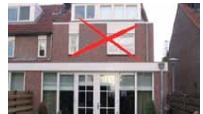
Uitbouw die in hoogte en detaillering niet goed aansluit; bijzonder, moet getoetst worden.
